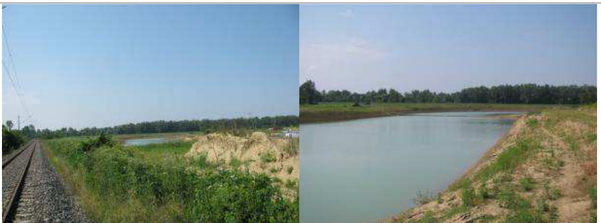
Slika 2.1-21. Propust na željezničkoj pruzi (lijevo) i nizvodni dio kanala 4. dionice od propusta ispod željezničke pruge (desno)
